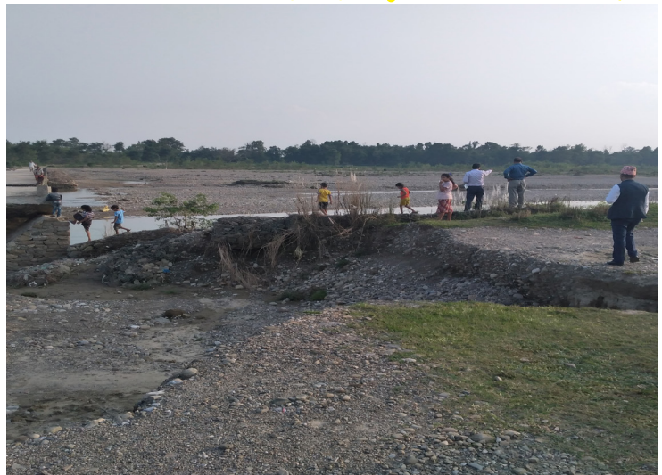
बाढीबाट क्षतिग्रस्त कजवेको अनुगमनको क्रममा
